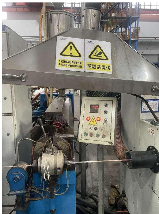
挤出机出口集气罩收集设施
